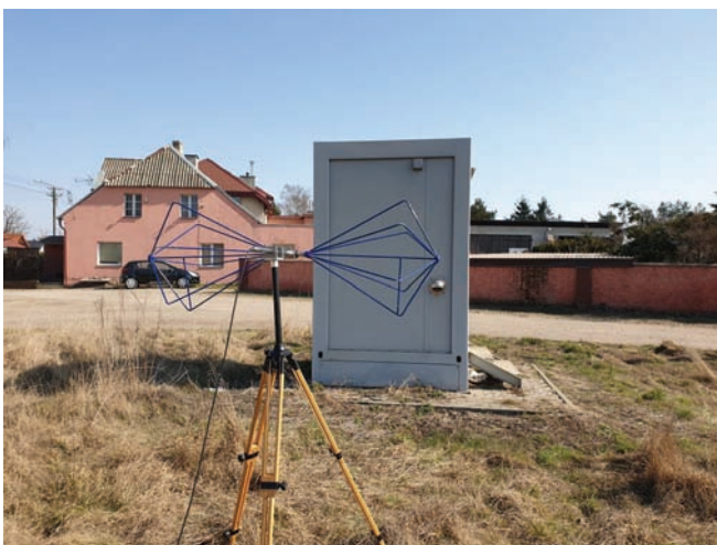
Rys. 11. Pomiar emisji zaburzeń promieniowanych od badanego kontenera teletechnicznego z pulpitem N1 [9]
