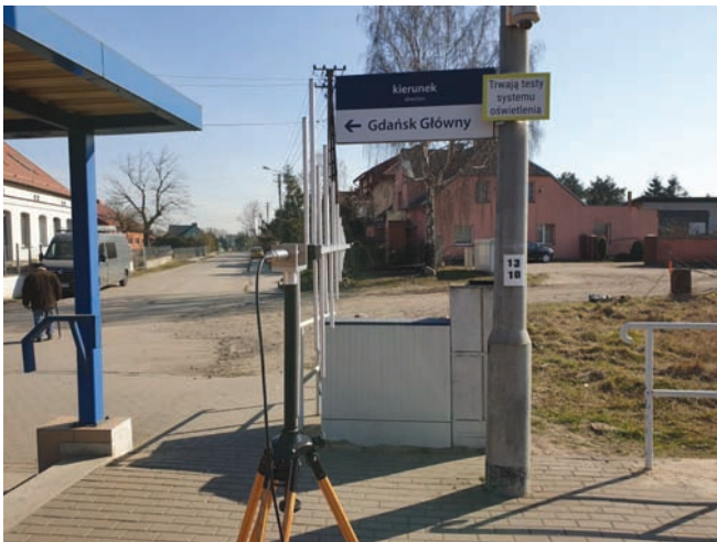
Rys. 10. Pomiar emisji zaburzeń promieniowanych od badanej szafy rozdzielczej sterowania oświetleniem terenów kolejowych RSO1 [9]
