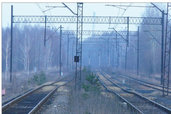
Rys. 2. Przykład deformacji nieciągłej (linia nr 149 stacja Knurów Szczygłowice; deformacje nieciągłe KWK „Szczygłowice”) [fot. W. Bała]
