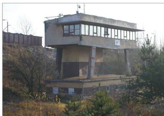
Rys. 3. Nastawnia na linii nr 131 Chorzów Batory – Tczew, st. Bytom Karb; szkody KWK „Bobrek-Centrum” [fot. W. Bała]
