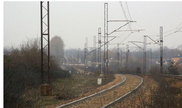
Rys. 4. Przykład zmian profilu podłużnego linii (linia nr 141 podg. Radoszowy – Ruda Kochłowice; szkody górnicze KWK „Halemba – Wirek”) [fot W. Bała]
