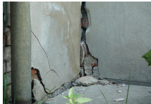
Rys. 6. Pęknięcia elementów konstrukcyjnych ścian nośnych (linia nr 149 stacja Knurów Szczygłowice, budynek nast. KN1; szkody KWK „Szczygłowice”) [fot W. Bała]
