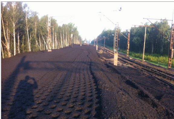
Rys. 11. Reprofilacja podtorza kolejowego w torze stacyjnym stacji Pawłowice Górnicze [fot. P. Gonddek]
