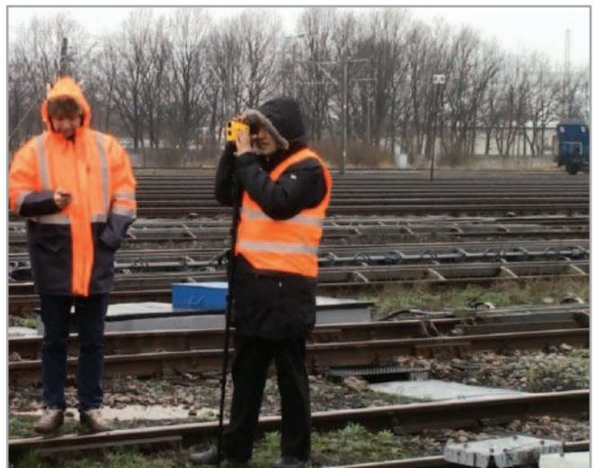
Rys. 12. Sprawdzenie poprawności funkcjonowania systemu SKT-1M za pomocą dalmierza laserowego TruPulse™ [fot. J. Tyszkowski]
