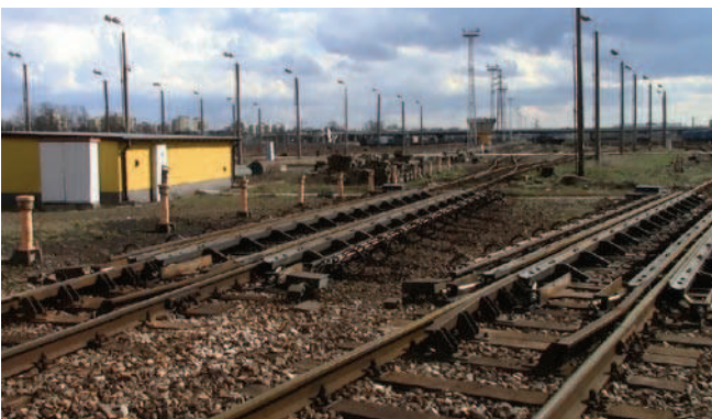
Rys. 3. Hamulce odstępowe typu ETH oraz budynek maszynowni w I strefie hamowania [fot. J. Tyszkowski]
