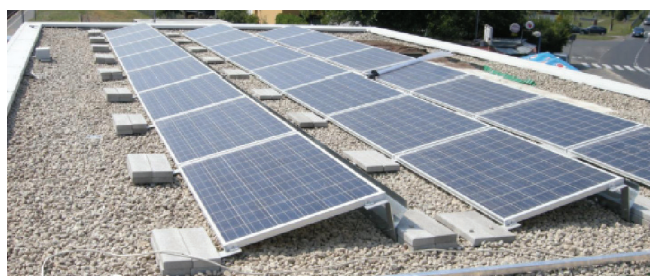
Rys. 1. Instalacja solarna na dachu IDS [zbiory PKP S.A.]
