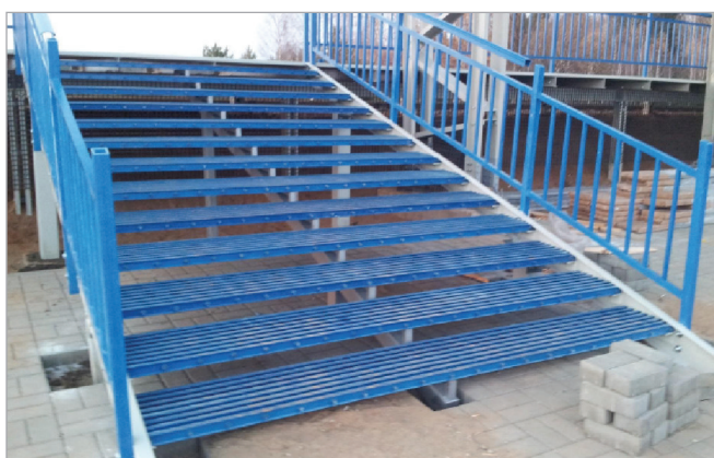
Rys. 10. Stopnie schodów wejścia na peron wykonane z profili wzmacnianych włóknem szklanym [16]
