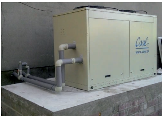
Rys. 6. Zewnętrzne urządzenie do schładzania wody komory klimatycznej [fot. autorzy]
